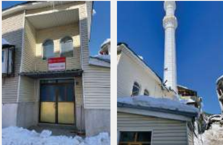
Şekil 3.62. Merkez Cami ve hasarlı minaresi
