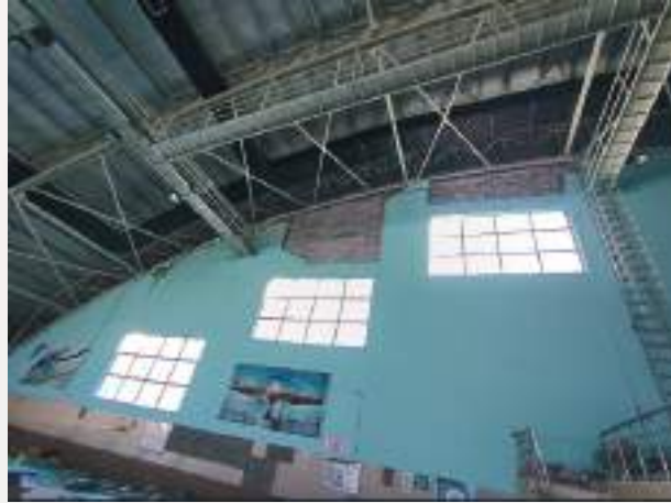
Şekil 3.52. Kalkan duvar hasarı
