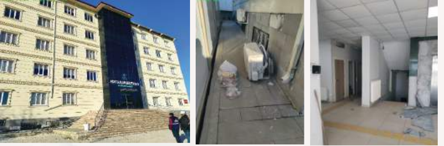
Şekil 3.54. Ek Bina ve zeminde oturma, merdiven hasarı
