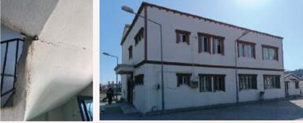
Şekil 3.51. Merdiven hasarı ve duvar hasarı
