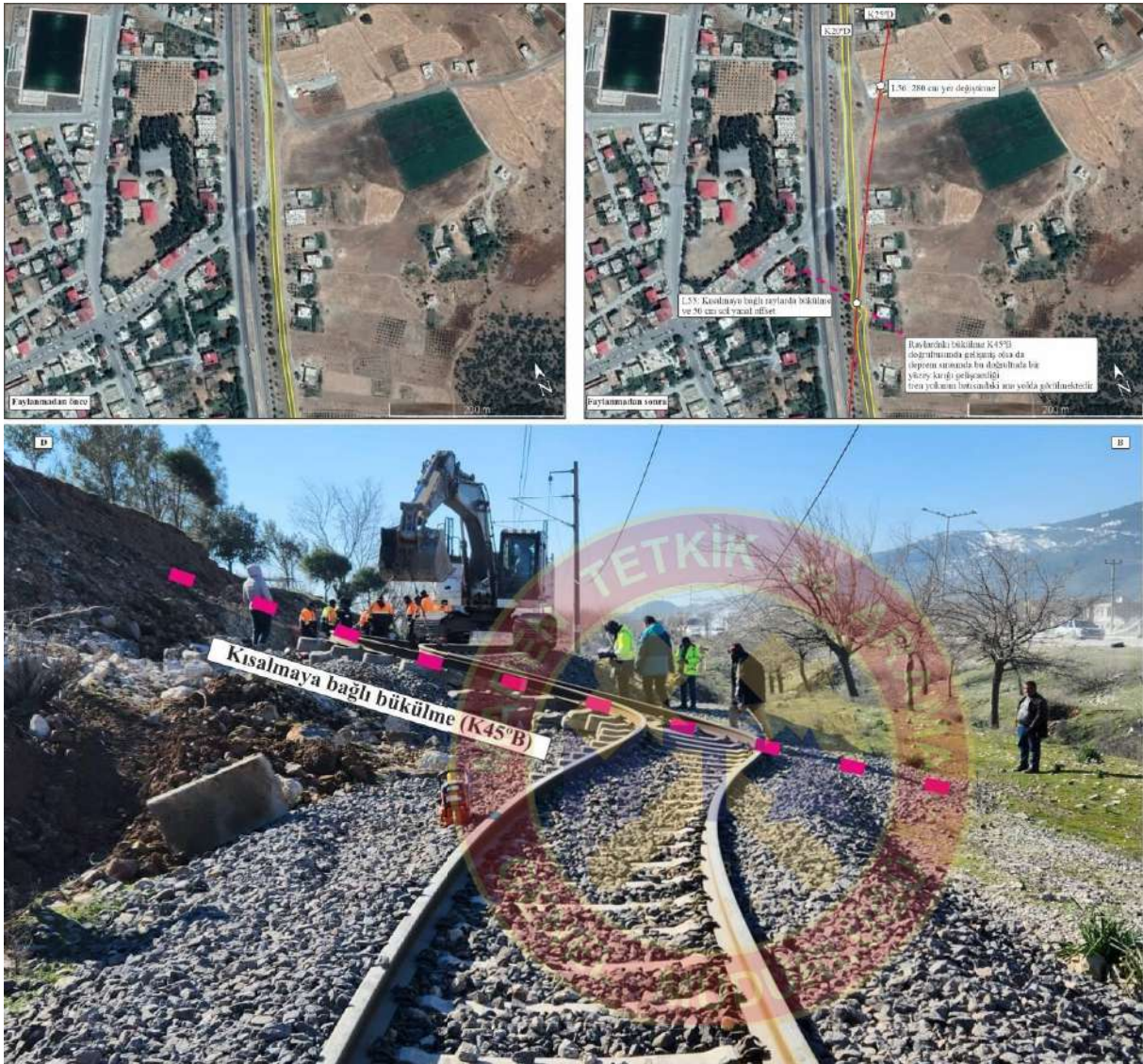
Şekil 4. 26. 06 Şubat 2023 Pazarcık (Kahramanmaraş) Depremi (Mw 7,7) sırasında Nurdağı ilçe merkezinin kuzeybatısındaki Şekeroba köyünün doğusundaki tren raylarında meydana gelen bükülmeyi ifade eden faylanma öncesi ve faylanma sonrası durumu resmeden Google Earth uydu görüntüleri ve arazi fotoğrafı.
