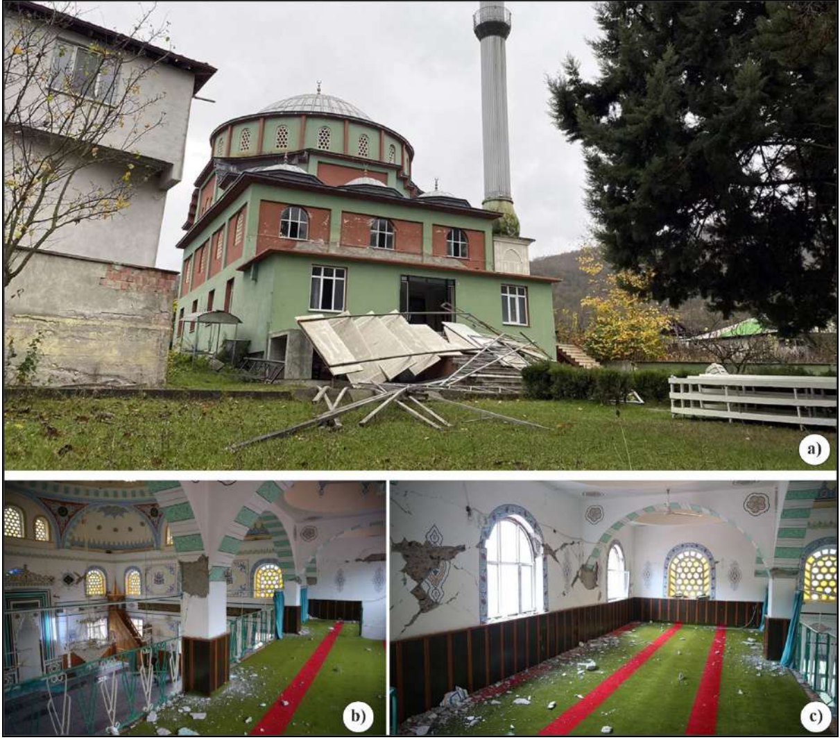
Şekil 4.14. Sarıdere Köyü (Gölyaka – Düzce) Camisi’nde meydana gelen yapısal hasar.
