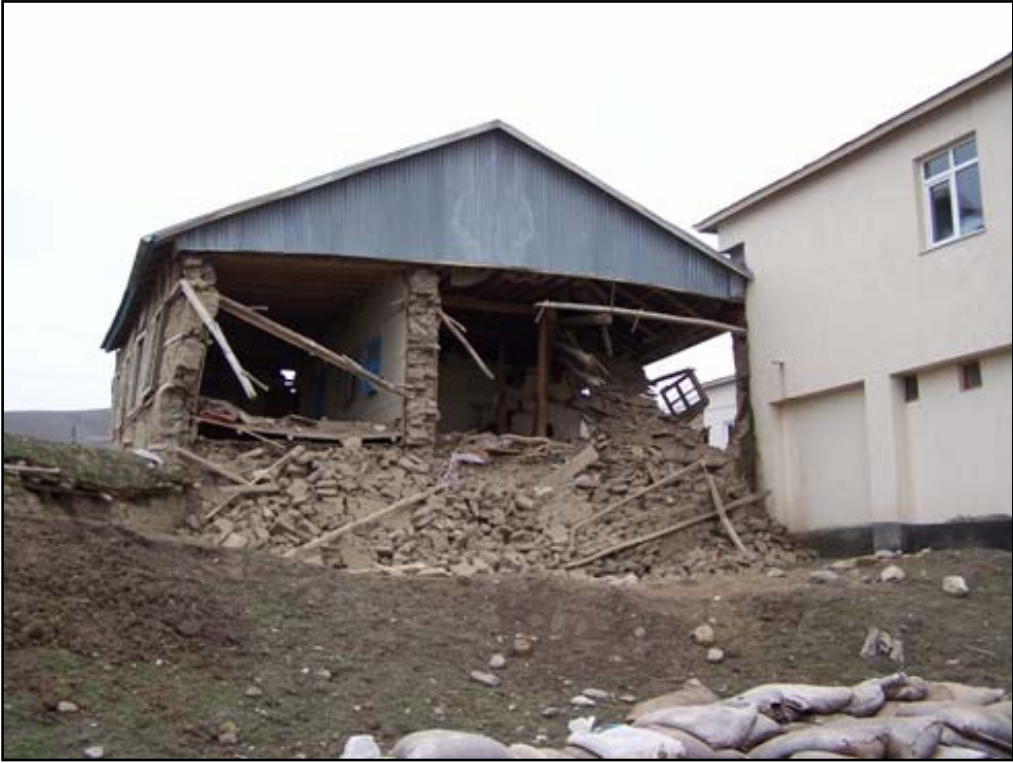
Şekil 22. Tabanözü Köyü'nde kerpiç sitili yapıda meydana gelen hasar ve hemen yanındaki betonarme yapı.
