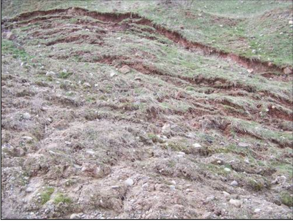
Şekil 19. Deprem sırasında Suvaran Köyü yöresinde meydana gelen yeni bir kayma.
