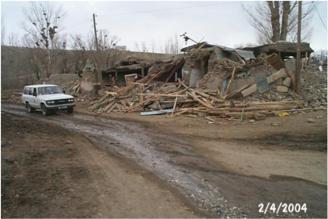
Foto 23: Tazegöl Köyünde geleneksel yığma yapılarda depremde meydana gelen hasar.
