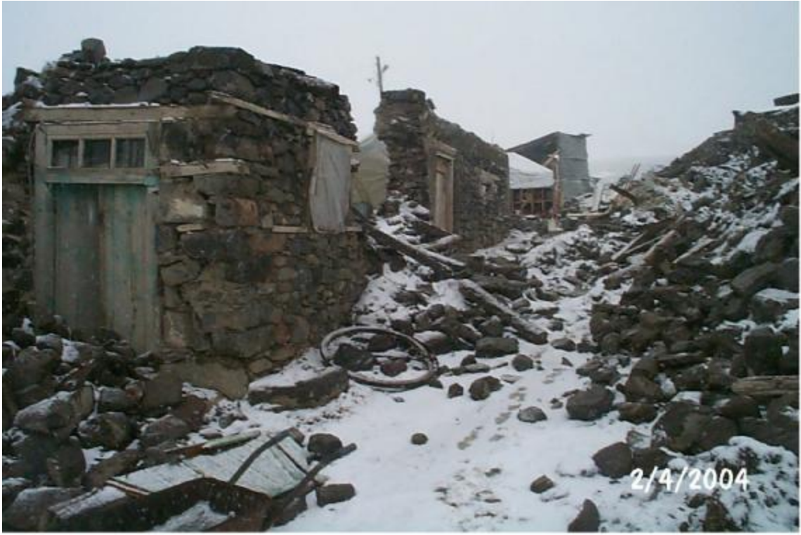
Foto 21: Atlıkonak Köyünde geleneksel yığma yapılarda depremde meydana gelen hasar.
