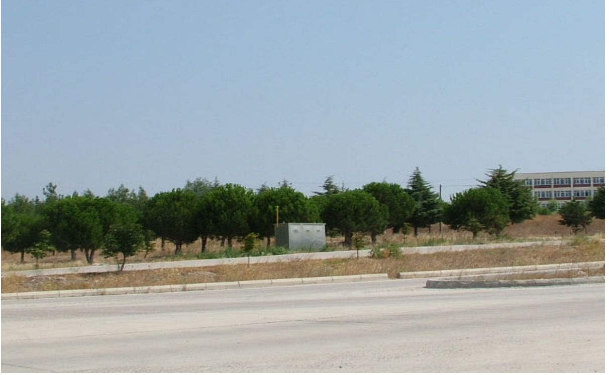
Doğal Gaz Dağıtım İstasyonu
